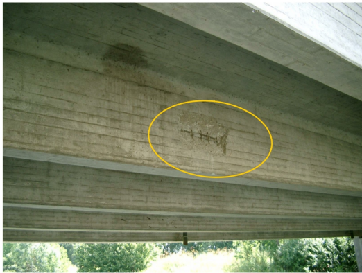
Bild 2: Brücke mit freigelegtem Hüllrohr
