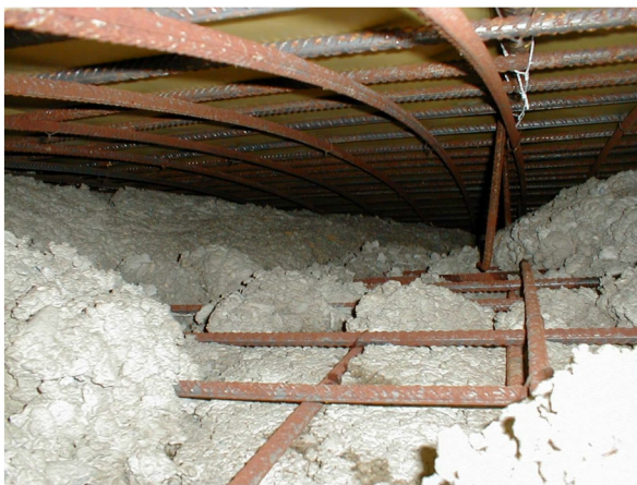
Bild 1: Hohlstelle im Gewölbefirst einer Innenschale mit sichtbarer innerer und äußerer Bewehrungslage
