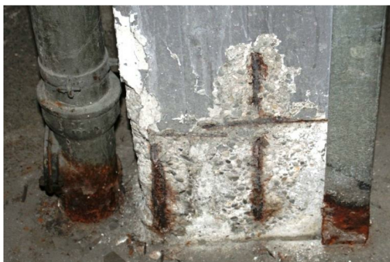
Bild 1: Durch Korrosion geschädigter Stützenfuß
