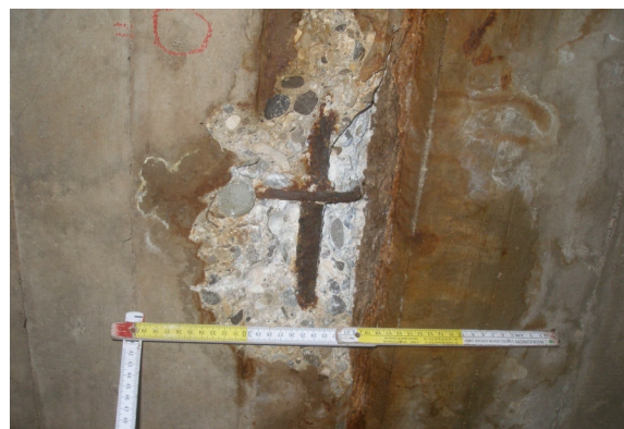
Bild 2: Undichte Dehnfuge zwischen zwei Unterzügen
